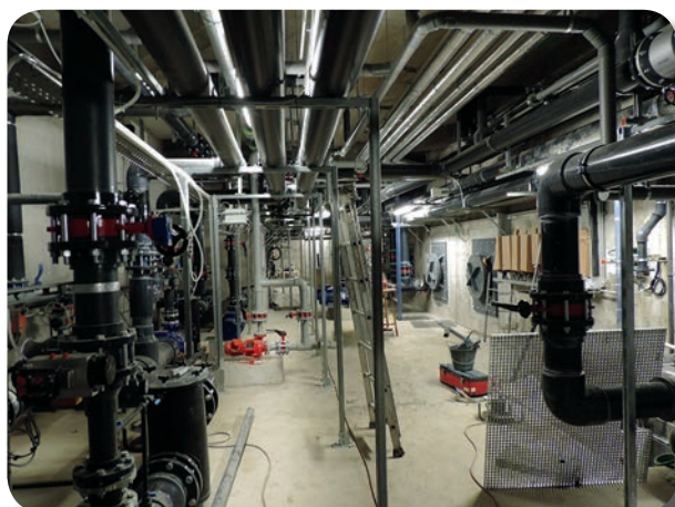
Des kilomètres de tuyauterie parcourent le sous-sol de la piscine
